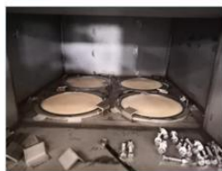
涂装尾气净化项目
