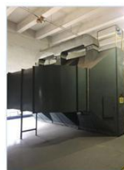
造船厂涂装车间尾气净化项目
